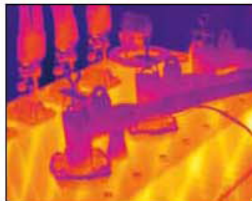
Infračervený snímek zapojení středního napávacího transformátoru
